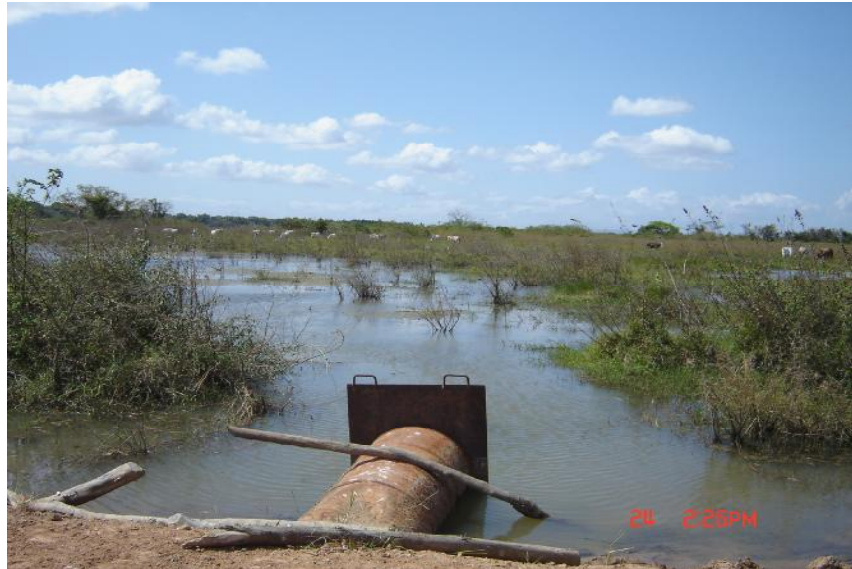
Fig. 3 Tubería de captación para riego
